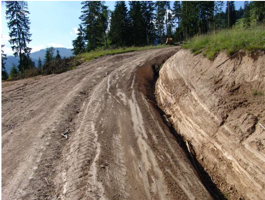
Figura 4. Ilustrarea impactului asociat unui drum forestier de exploatare; se observă ogașele profunde cauzate de fenomenele erozive, tasările generate de târârea arborilor și zonele extinse de afectare ca urmare a insuficientei pregătire a zonelor de schimbare a direcției
