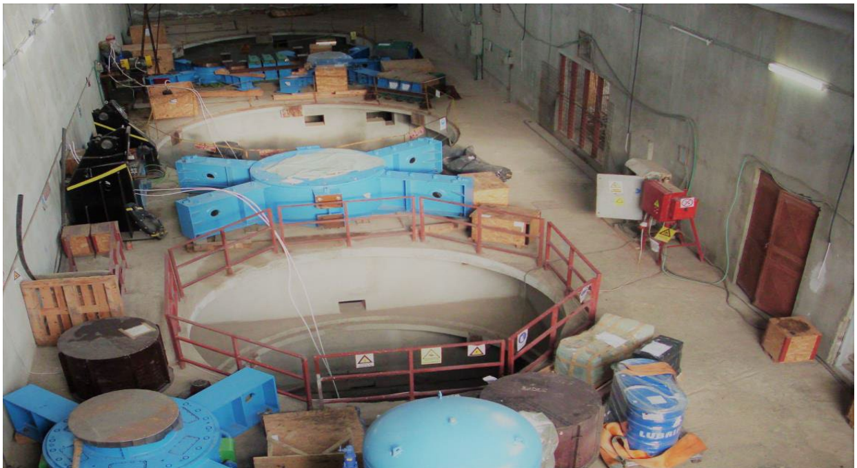
Figura 8. Echipamente livrate și depozitate în interiorul CHE Pașcani
