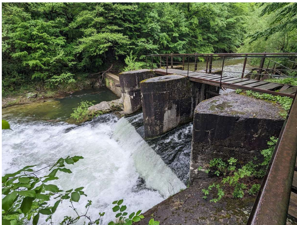
Figura nr. 205 Exemplu de fragmentarea situată pe râul Cerna la aproximativ 1 km de limita din aval a sitului și a Parcului Național Domogled – Valea Cernei (în afara arealului proiectului)
