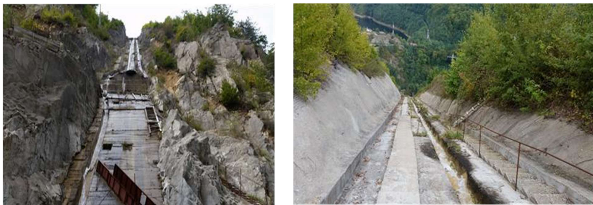
Figura nr. 48 Infiltrații din galeria principală pe traseul conductei forțate
