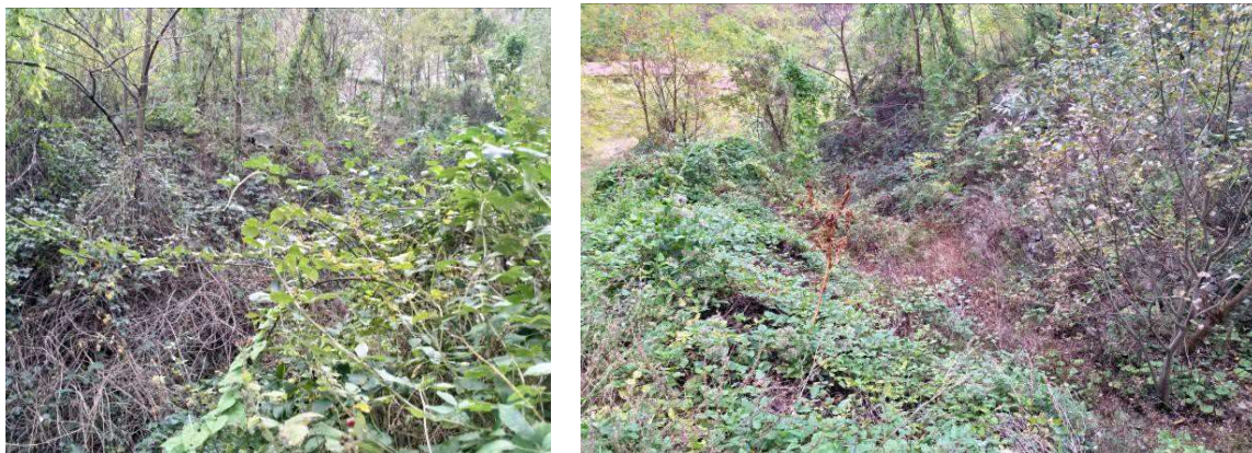
Figura nr. 50 Șenal colmatat adiacent tranșei conductei forțate
