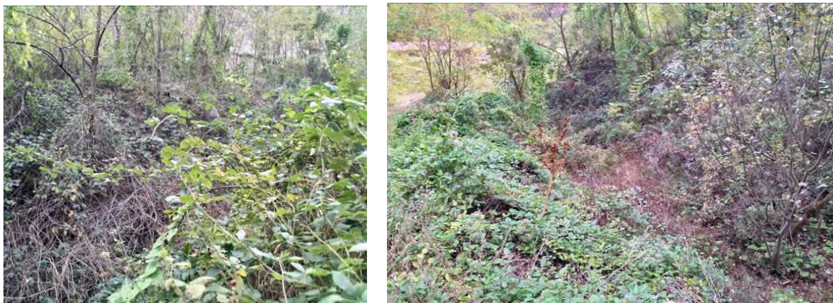
Fig. 50 Șenal colmatat adiacent tranșeei conductei forțate
