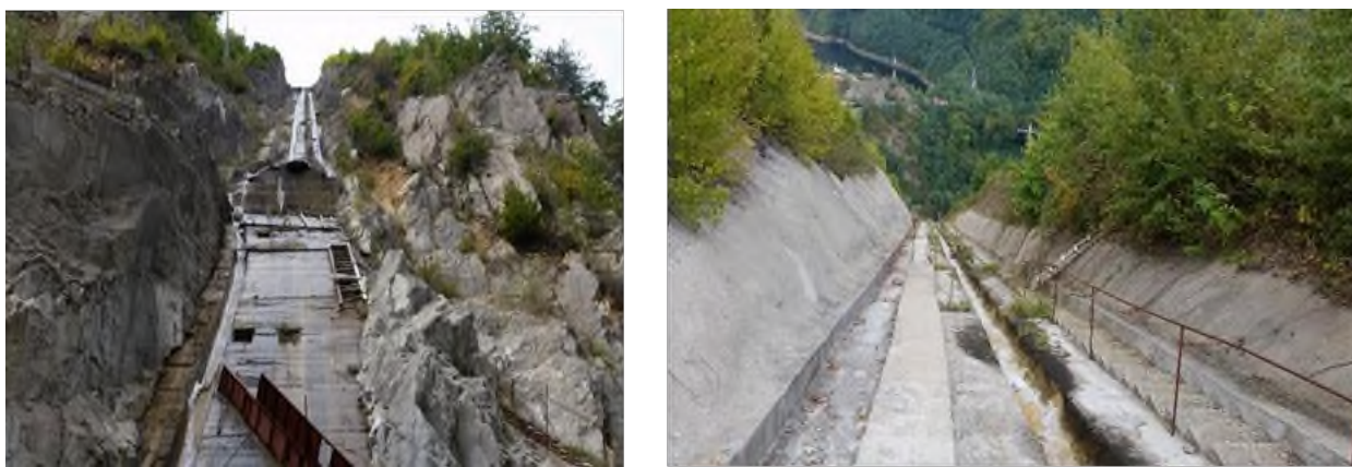
Fig. 48 Infiltrații din galeria principală pe traseul conductei forțate
