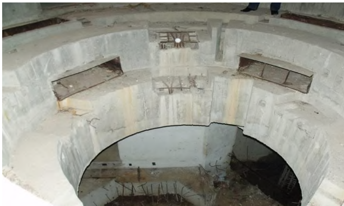
Fig. 52 CHE Herculane. Fundație generator HA3
