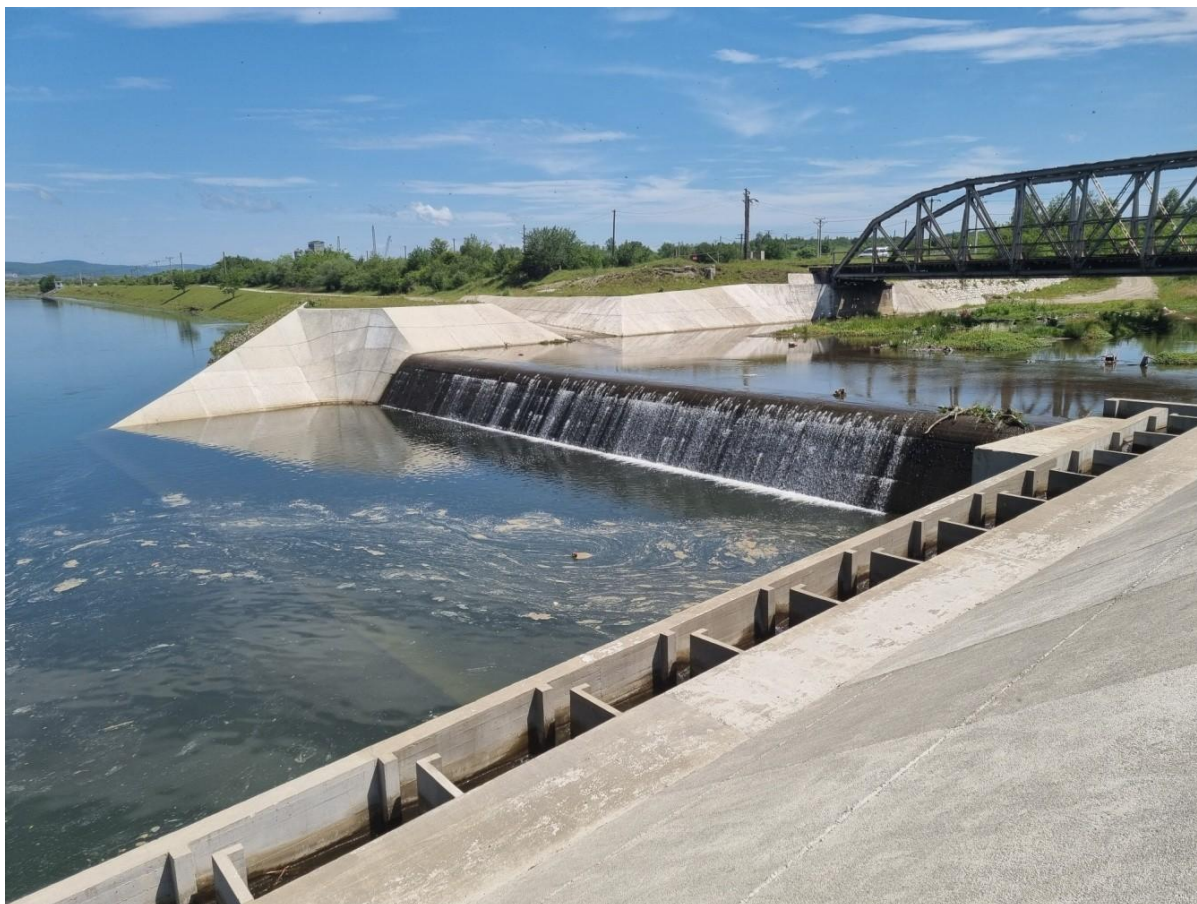
Foto nr. 62 Deversor confluență pr. Șebeș cu r. Olt
