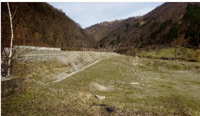
Foto 9. Dig mal drept – zona de racord cu centrala – ecran tip Kelly executat și umpluturi în corp dig pe cca. 1,0 m înălțime
