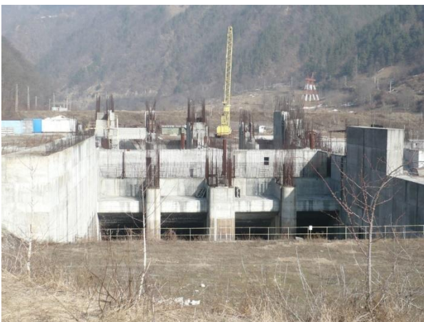
Foto 11. Centrala și bazinul de liniștire – vedere din aval
