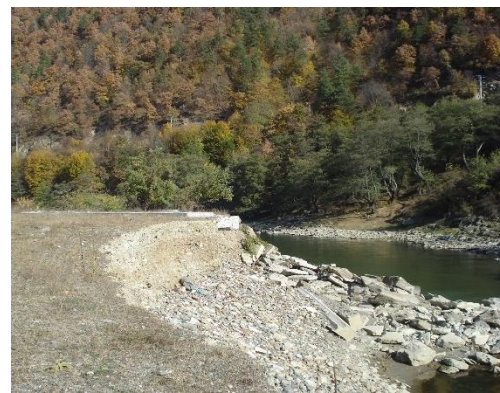
Foto 10. Dig mal drept – amonte racord cu centrala – umplură platformă ecran tip Kelly spălată de apele mari pe cca. 4-5 m lățime și grinzile de ghidaj prăbușite
