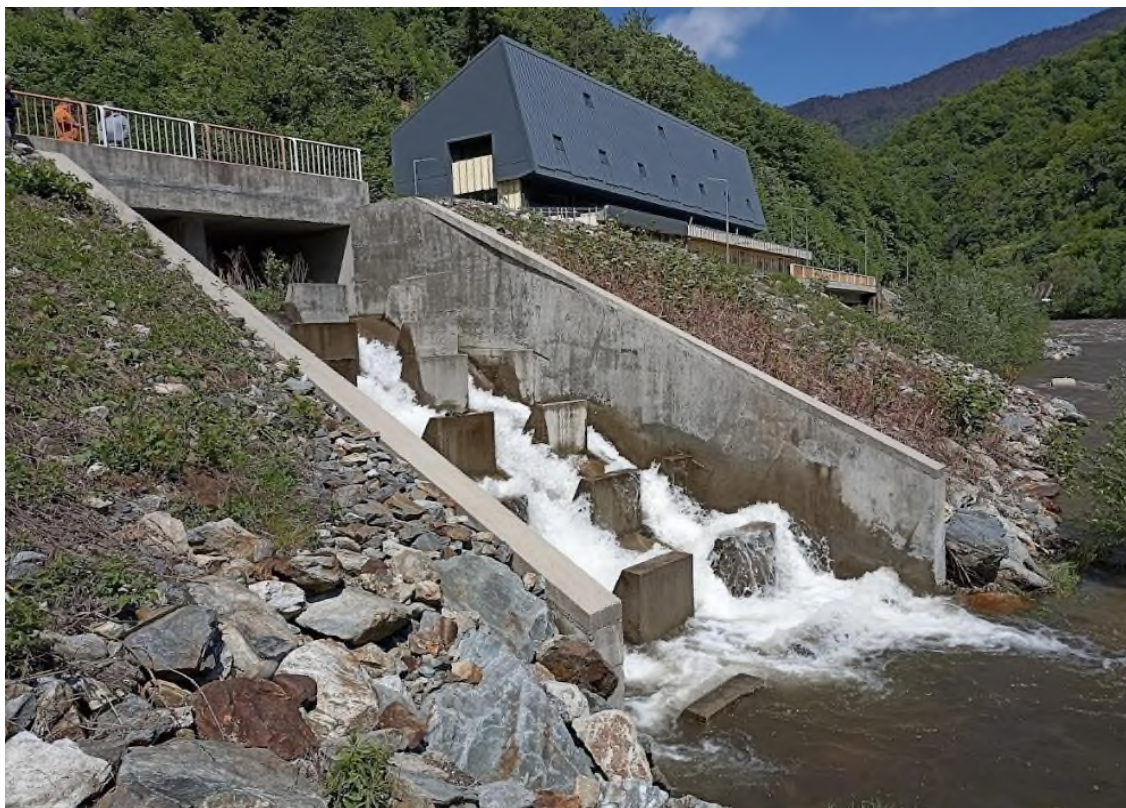
Fig. 148 Întreruperea conectivității longitudinale la nivelul confluenței pâ râului Dumitra cu râul Jiu
